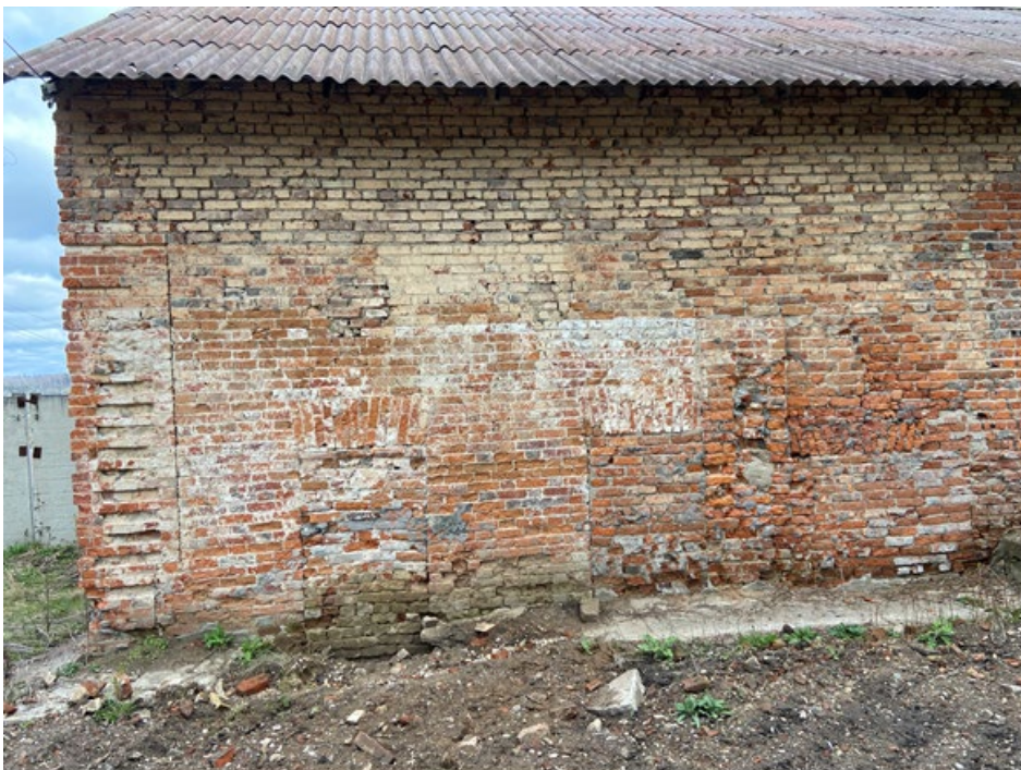
Фото 18. Фрагмент юго-западного фасада. На фрагменте фасада кладки трех разных строительных периодов, многочисленные перекладки.
