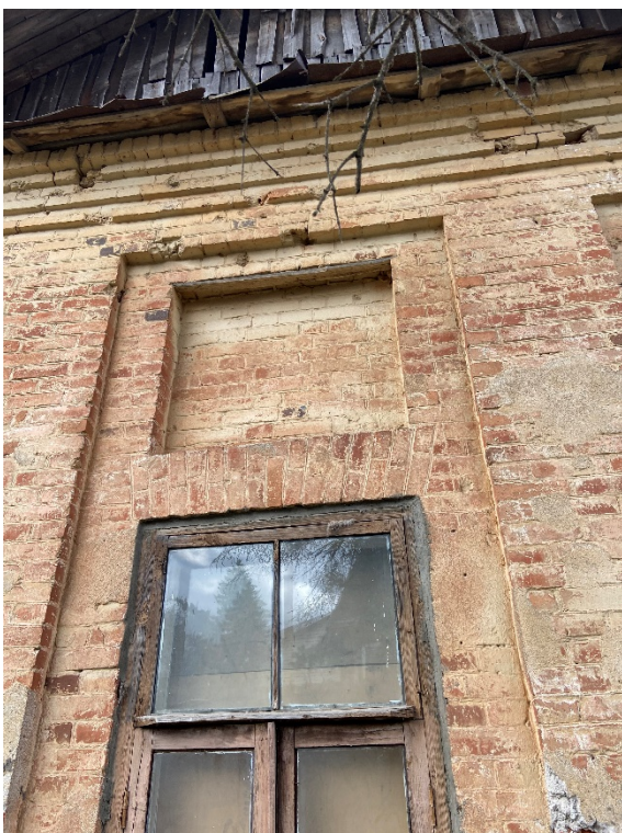
Фото 14. Фрагмент юго-восточного фасада, центральное окно. Кладка стены в хорошем состоянии. Имеются незначительные утраты кирпича.
