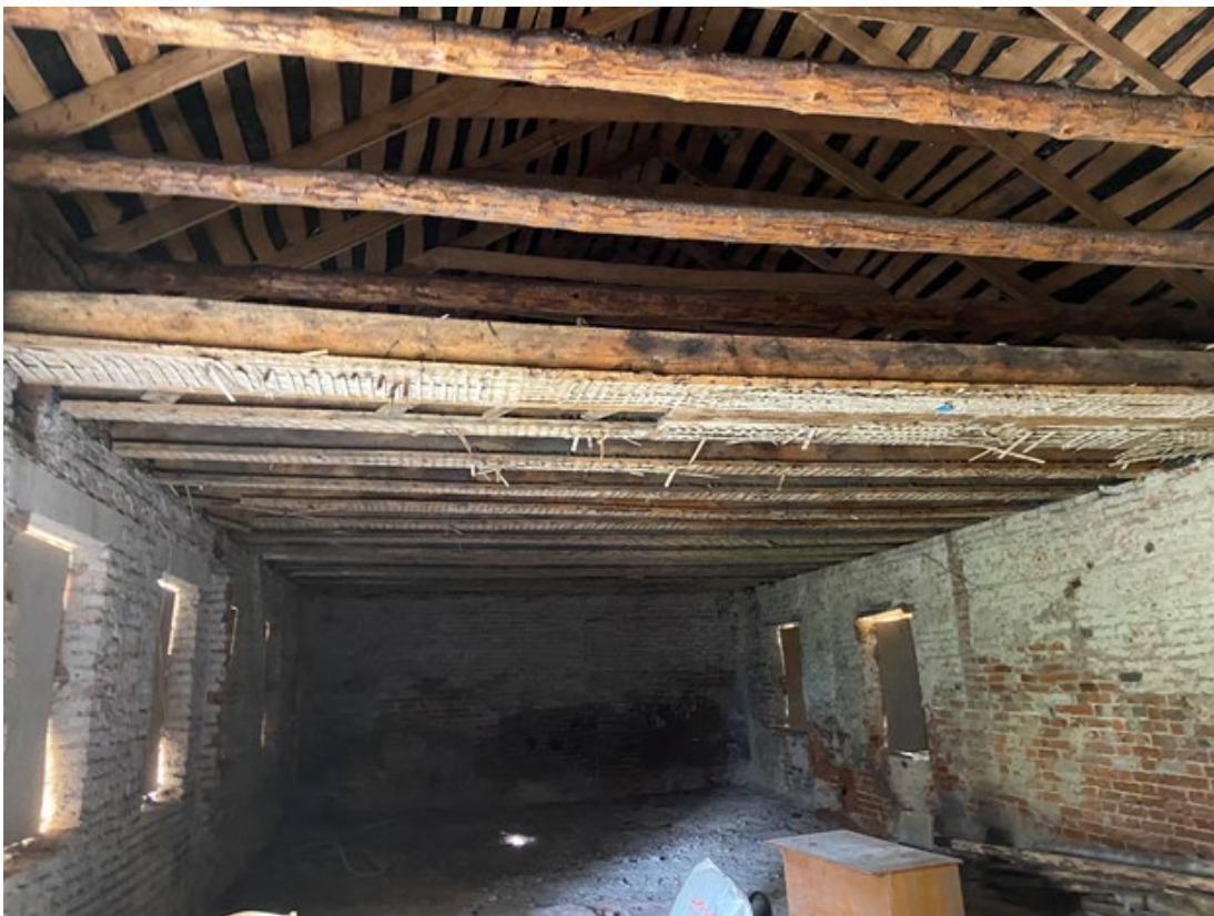
Фото 24. Центральный объем. Вид на западную капитальную стену. Деревянная стропильная система кровли расположена над всем зданием, балки перекрытия частично разобраны
