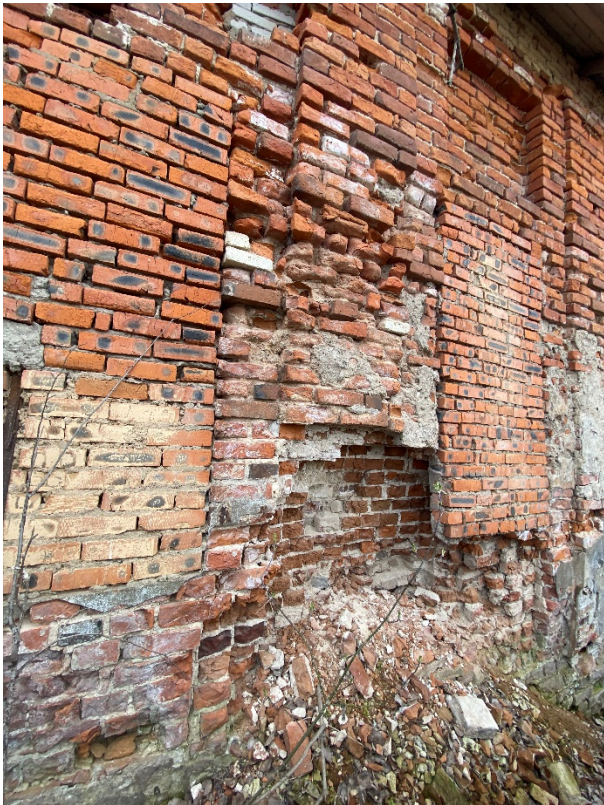
Фото 9. Фрагмент северо-восточного фасада. Основная кладка стен имеет утраты, разрушения лицевого слоя кирпича, выветривание кирпича и раствора.
