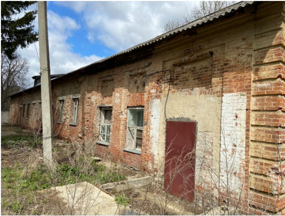
Фото 15. Юго-западный фасад. Объем западной пристройки кон. XVIII в. сохранил декор и пластику фасада. Кладка стены в удовлетворительном состоянии.
