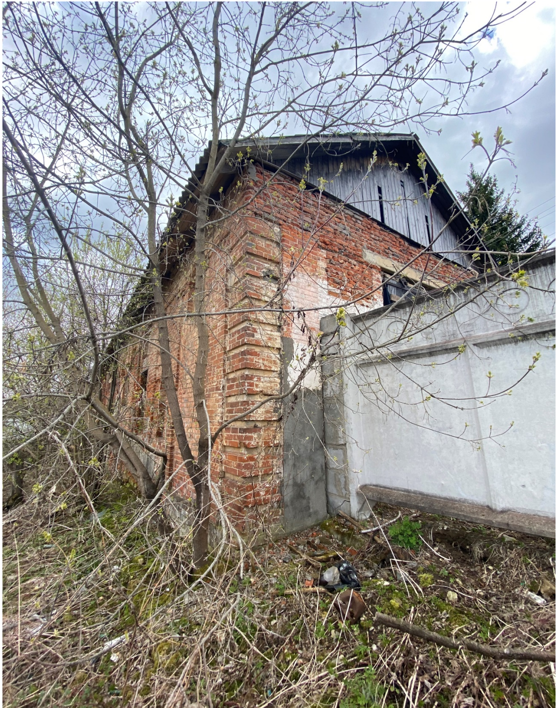
Фото 3. Угол северо-восточный и северо-западного фасадов. Угловой руст. Венчающий карниз утрачен.
